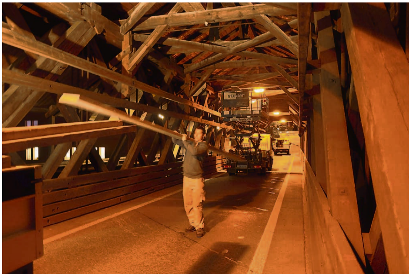
Zimmerleute der Hägendörfer Holzbaufirma Peter Studer Holzbau AG verlegten im Auftrag des Kantons im Dachstuhl der Holzbrücke zwischen Fulenbach und Murgenthal einen Montagesteg. ZVG
