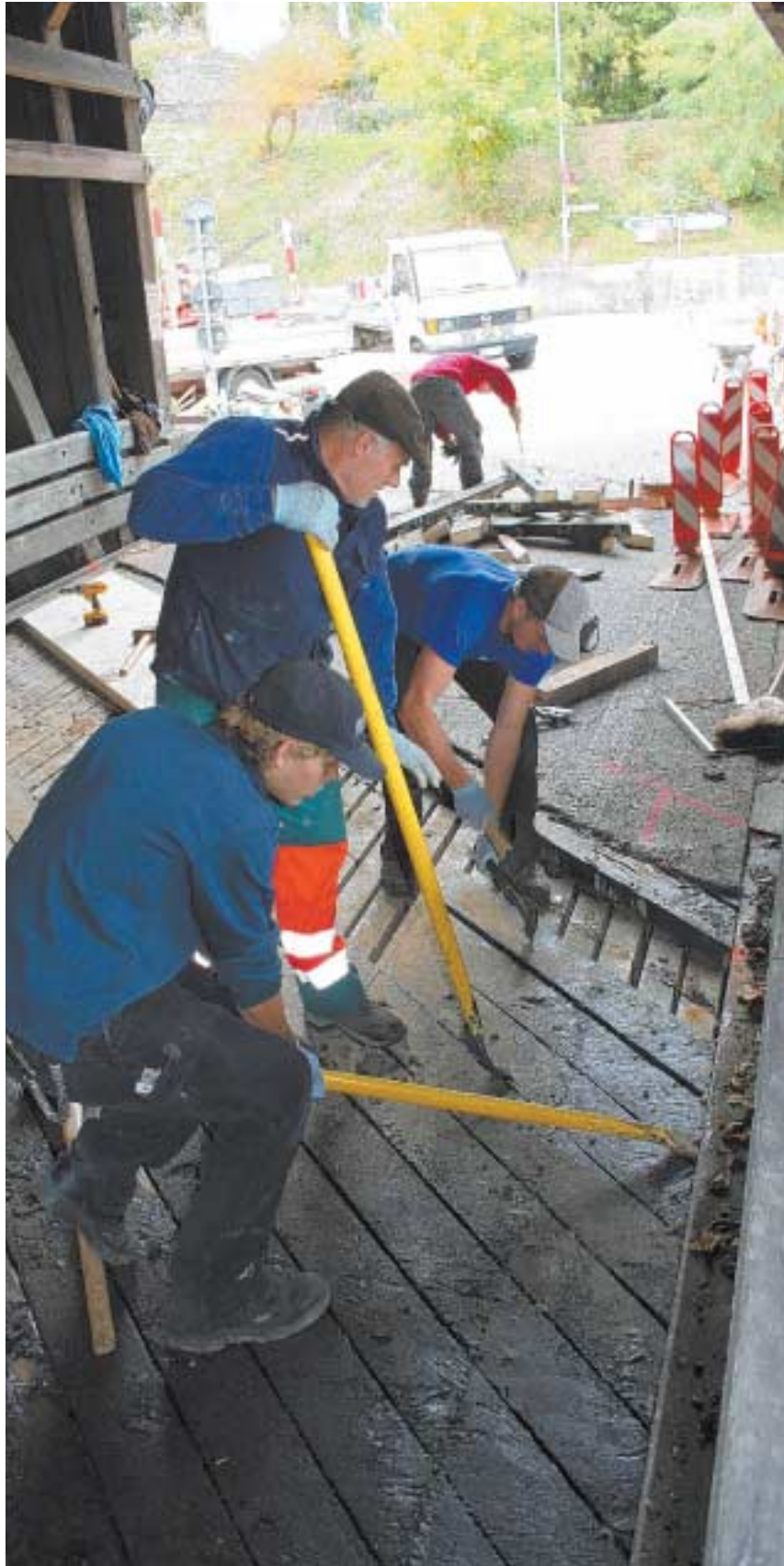
Weg mit alten Balken und Bohlen: David Hugentobler (rechts) und Co. an der Arbeit. NIK
